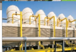
Cooling tower (D)
